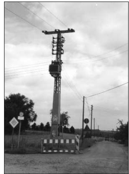
Über Stahl- und Holzmasten wird heute der elektrische Strom in die Dörfer verteilt (4)
