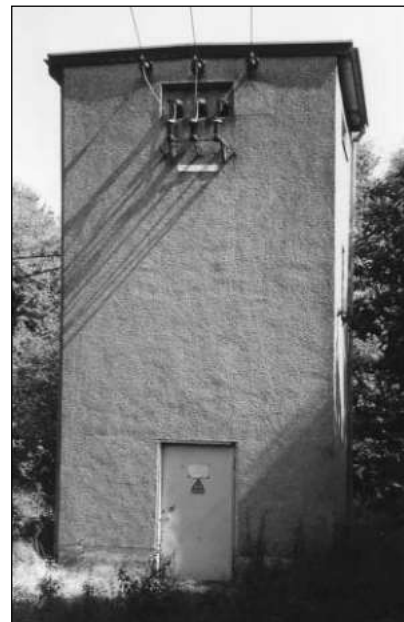
Über die Trafostation Siegburg-Stallberg wurden die Gemeinden Inger, Breidt und Halberg versorgt (6)
