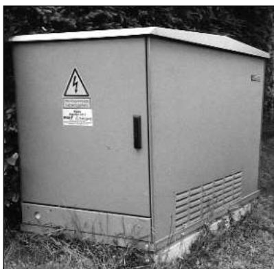
Die Technik erlaubt heute kleine Transformatoren in den Dörfern (11)
