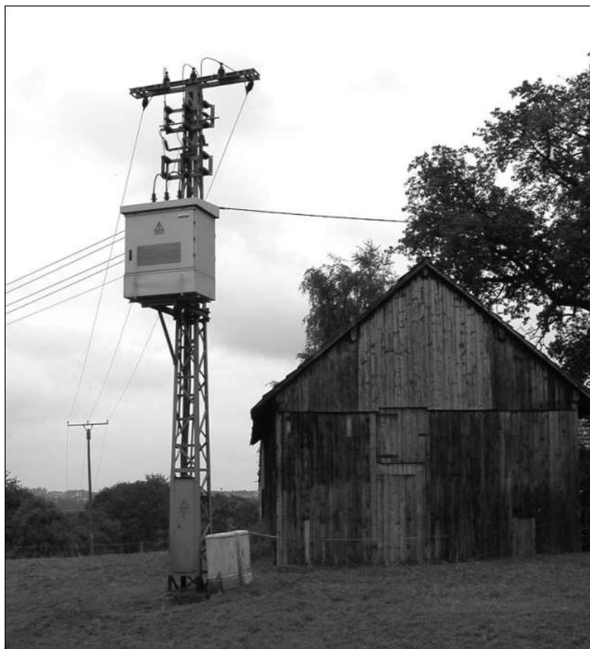
Ein Transformator in Höffen versorgt die umliegenden Häuser mit Strom (2)
