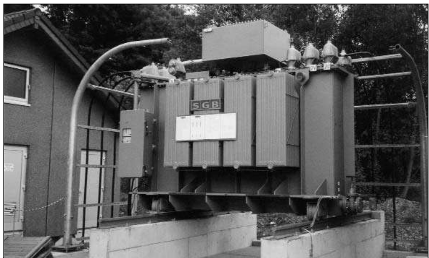
Trafo des RWE in Bachermühle, ein wichtiger Einspeisepunkt des RWE. (15)
