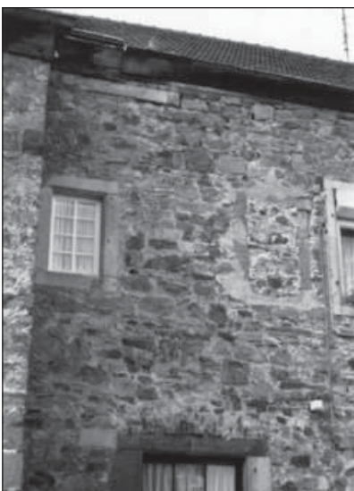
Dass im Laufe der Jahrhunderte bauliche Veränderungen stattfanden, zeigt das vermauerte Fenster im nördlichen Gebäudeteil. Insgesamt zeigen sich überall am Gebäude Putzreste auf dem bunt gewürfelten Mauerwerk. Das gesamte Burghaus war demnach einmal völlig verputzt und farbig gefasst. (9)
